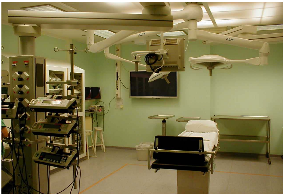
Figur 5, Nevrokirurgisk operasjonsstue med kontrollpanel, Plasmaskjerm, og monitorarm i operasjonslampe
